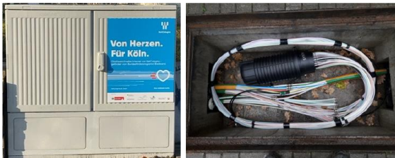
Glasfaserverteilung (Schrank oder Muffe)
