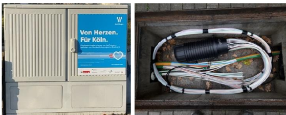
Glasfaserverteilung (Schrank oder Muffe)
