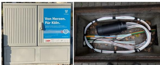
Glasfaserverteilung mittels Schrank oder Muffe
