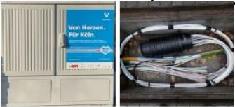
Glasfaserverteilung mittels Schrank oder Muffe
